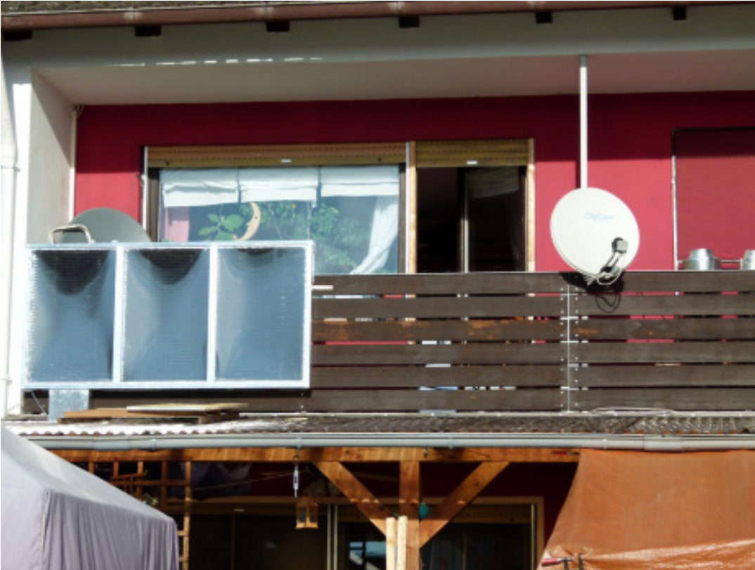
Mitte Januar wurde der Kollektor am Balkongeländer montiert, aber noch ohne Luftleitung.
